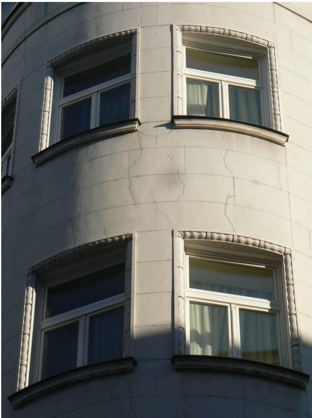
(íves kialakítású homlokzaton látható, javított, tömített repedések)
