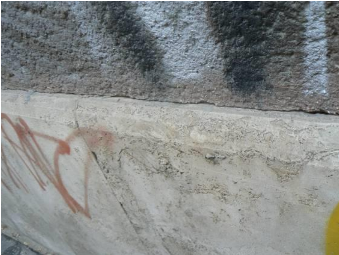
A vakolat és a kőlap közötti repedésbe befolyik a csapadék, mely károsítja a falszerkezetet, s a kialakult hó híd itt a belső falfelületeken penészedést okozhat.
