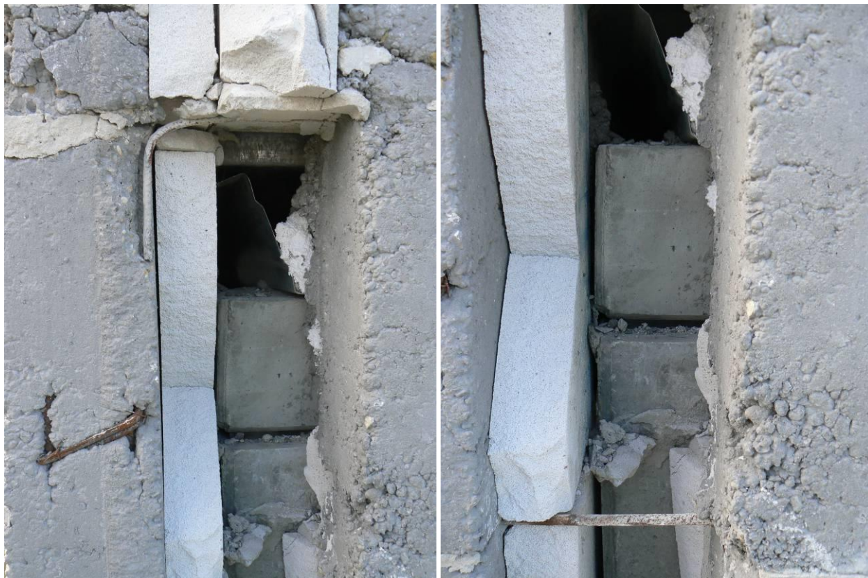
A látható előregyártott pillérekhez a merevítő betonozás nélküli pillérek nincsenek bekötve!
