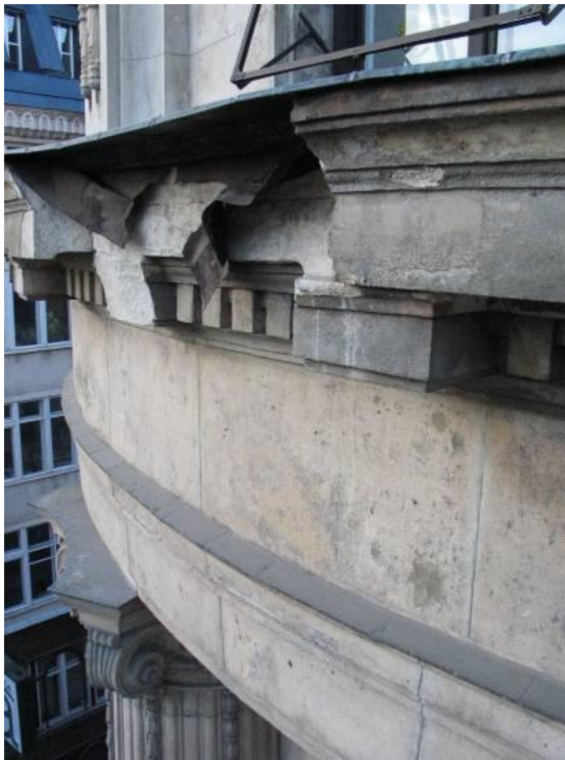
Értéktőzsde (a leszakadt kőelem az előtetőt összezúzta, senki nem volt alatta.)
