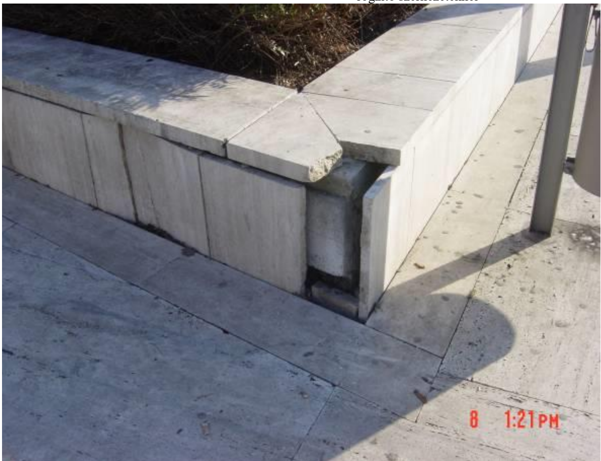
Padló és falburkolat szakszerűtlen csatlakozása
