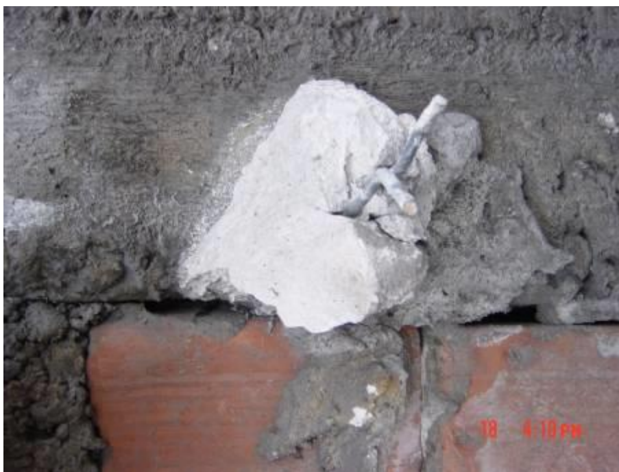
Bronz kapcsolódót és gipsz kapcsolata, nincs károsodás
